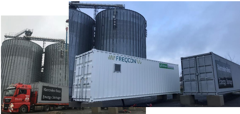
Großbatterie als Containerlösung bei der Westerwälder Holzpellets GmbH
