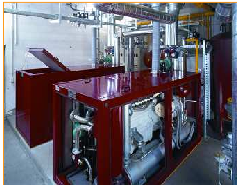
Klärgas- und Erdgas-BHKW á 110 kW el | 200 kW th
