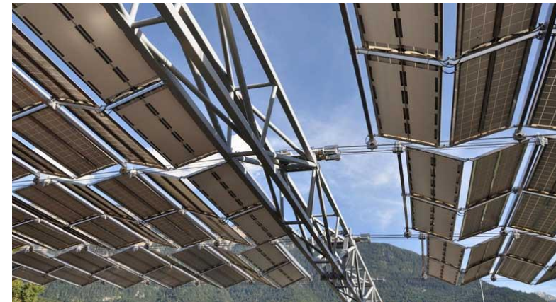
Beispiel: Faltdach der Kläranlage ARA Chur
