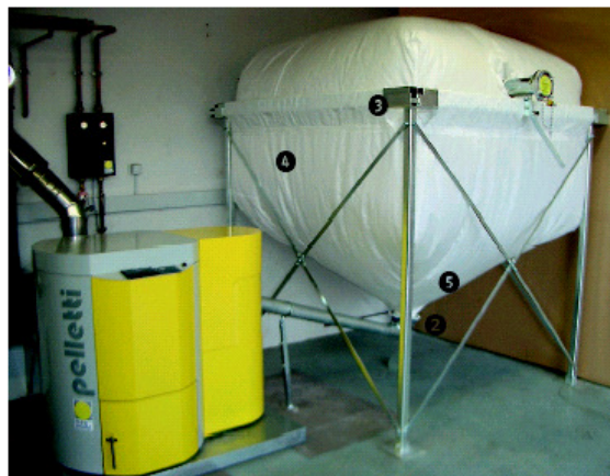
Abbildung 2-4 Holzpelletskessel mit Gewebesilo (Quelle: Soltec Energiekonzepte im System)
